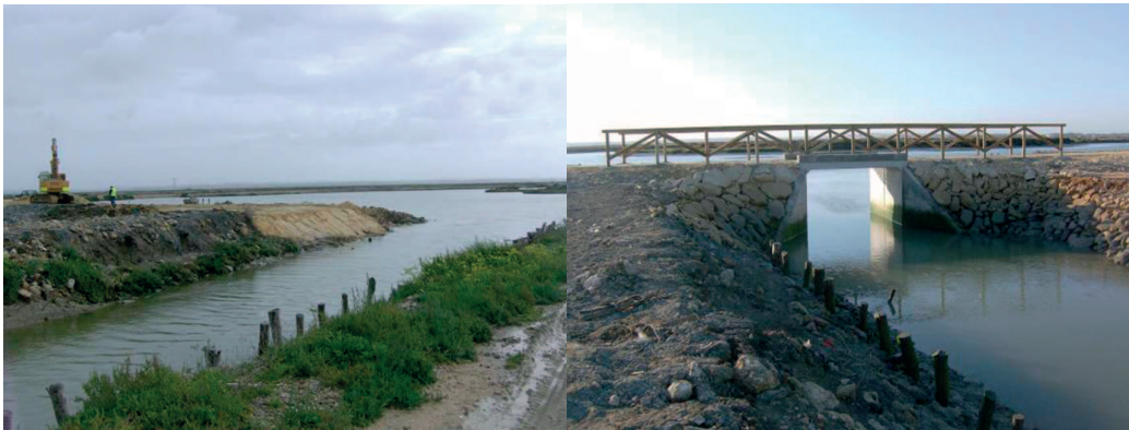
Figura 13: Vistas del estado anterior y posterior a la colocación de un marco de hormigón Fuente: Demarcación General de Costas.
