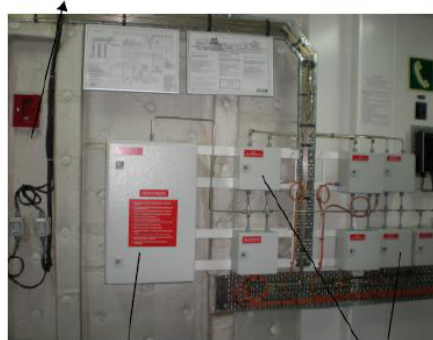
VALVULAS PILOTO CAJETINES DE LA ZONA A DISPARAR
