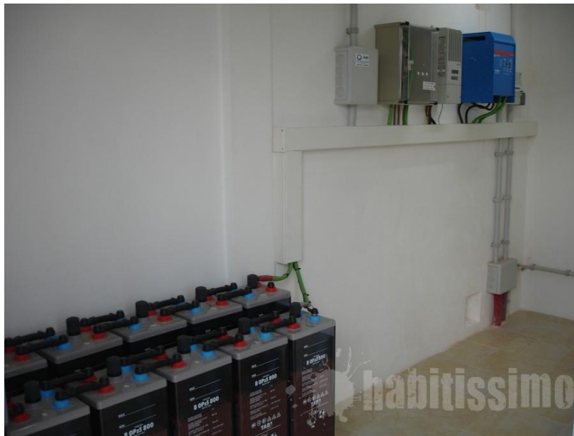
Ilustración 46 Instalación de baterías, regulador, inversor y cuadro de protecciones.
