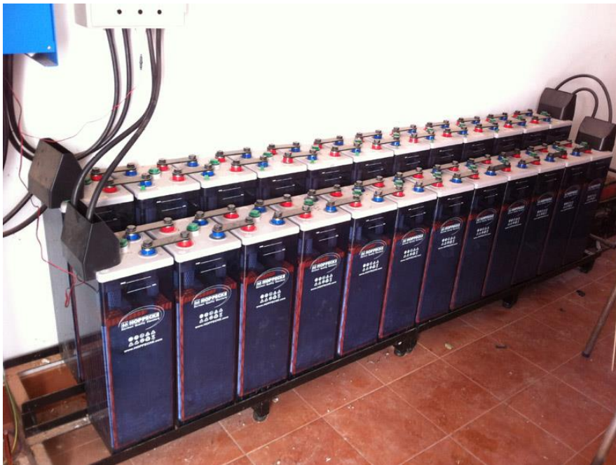
Ilustración 45 Bancada de baterías instaladas
