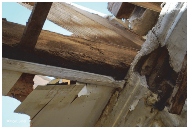
Figura 1. Pudrición de la techumbre.
