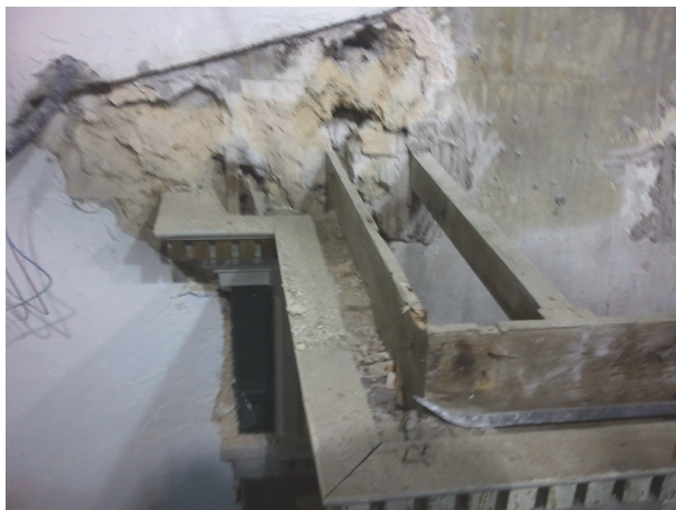
Figura 2. Deterioro del muro y los retablos.
