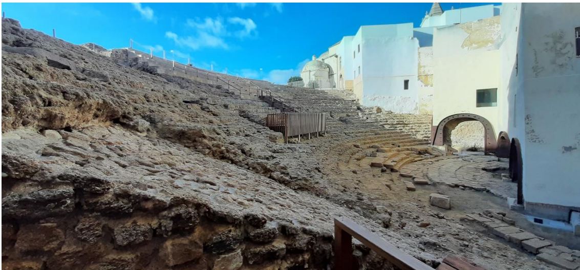
Figura 15 Vista de la cavea desde uno de los vomitorios donde se puede apreciar el estado de conservación.
