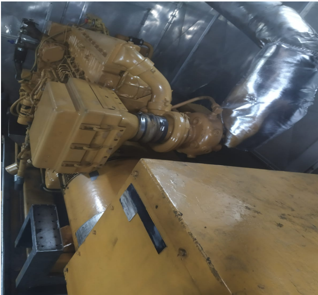
Figura 10. Motor A vista turbosoplante y colector de gases de escape Fuente: Elaboración propia
