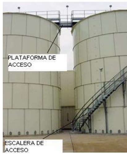
Figura 2. Tanques cilíndricos verticales con escaleras y pasarelas con barandales [10]
