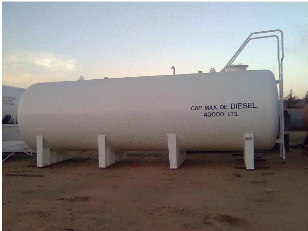
Ilustración 11: Tanque de almacenamiento horizontal
