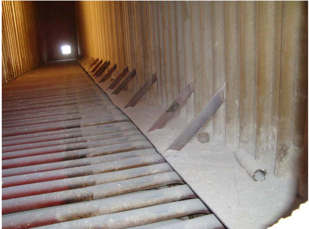
Ilustración 16: Horno de una central eléctrica de carbón
