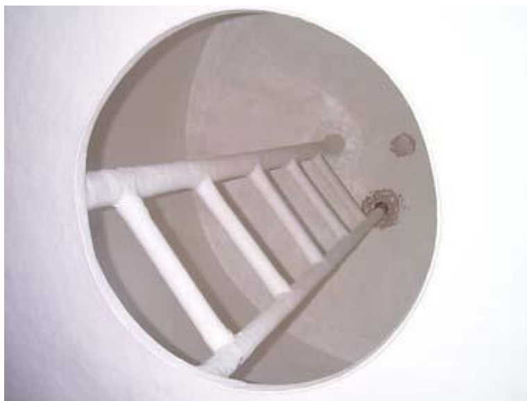
Ilustración 2.6 Boca hombre de un tanque de almacenamiento
