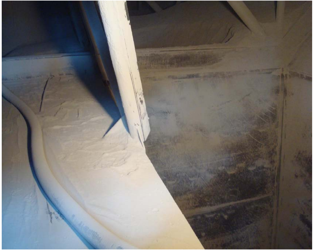
Ilustración 7.6 Interior tolva de una central eléctrica de carbón
