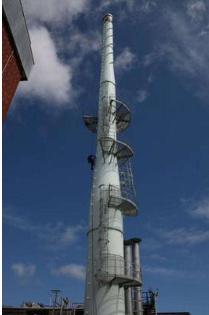
Ilustración 3: Chimenea de acero
